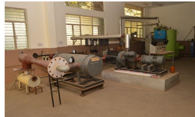
Mini Power plant
